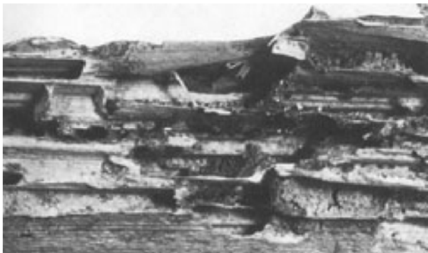
Fig. 2. Daño en forma de “hoja de libro” causado en la madera por Reticulitermes lucifugus al abrir galerías paralelas a la dirección de sus fibras, entre las que van dejando delgadas tiras sin afectar.
